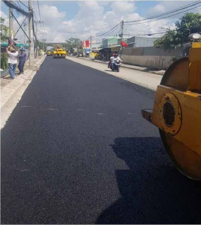
- Chủ đầu tư: Ban Quản lý dự Án Đầu tư Xây dựng Khu vực huyện Bình Chánh / Investor: Management Board of Investment and Construction Projects of Bình Chánh district. - Công trình: Nâng cấp đường và xây dựng hệ thống thoát nước đường Nữ Dân Công - Gói thầu: Thi công xây dựng công trình - Địa điểm: Xã Vĩnh Lộc A, Huyện Bình Chánh, Tp.HCM / Improvement of road and construction of drainage system on Nu
